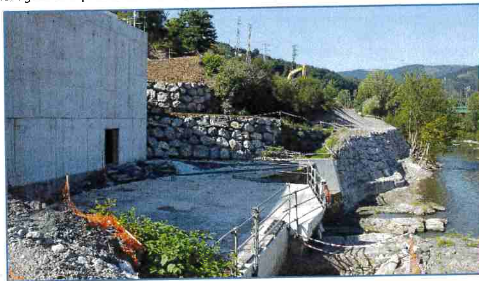
Fig. 3. Captación del río Nervión
