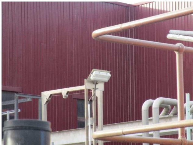
Lugar: EDAR GALINDO Edificio: I01 – Desarenado Comentario: Alumbrado de emergencia.
