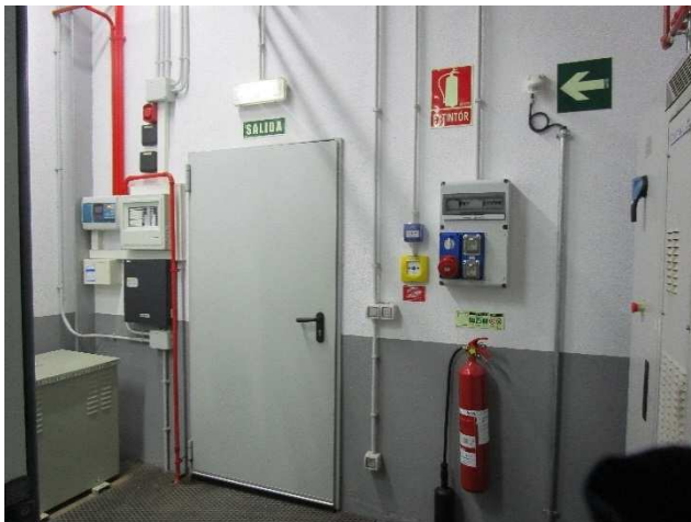
Lugar: EDAR GALINDO Edificio: I23 – Horno 3 Comentario: Sistema fijo de extinción, extintor, alarma y pulsador en el cuarto de CCM de la planta baja.
