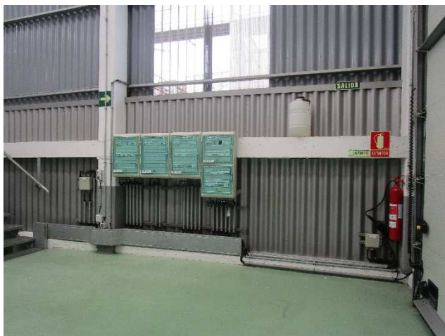
Lugar: EDAR GALINDO Edificio: E24 – Rototamices Comentario: Extintor CO 2 y cuadros eléctricos sin alumbrado de emergencia (incorrecto).
