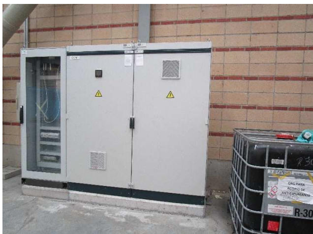
Lugar: EDAR GALINDO Edificio: E21 – Almacén de contenedores Comentario: Cuadros eléctricos sin luz de emergencia (incorrecto).
