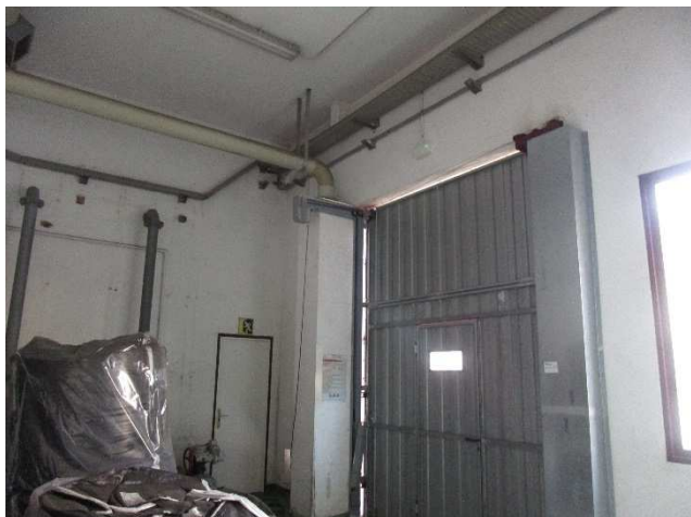
Lugar: EDAR GALINDO Edificio: E15 – Almacén y Vestuarios Comentario: Alumbrado de emergencia y señalización de evacuación en puerta de acceso.
