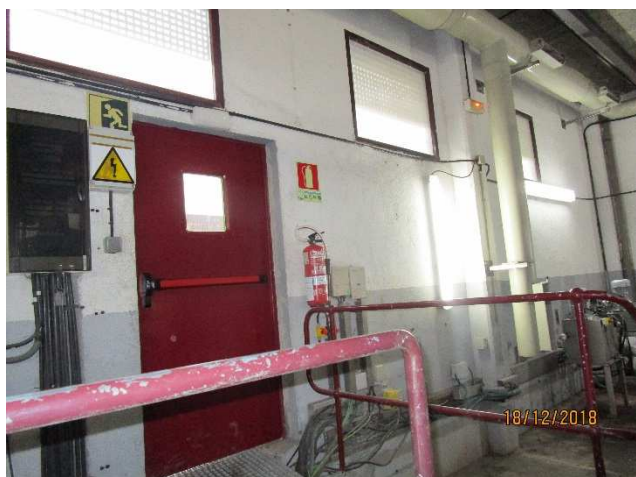
Lugar: EDAR GALINDO Edificio: E05 – Tamizado de Fangos Primarios Comentario: Extintor ABC, alumbrado de emergencia y señalización de evacuación sobre la puerta de acceso a planta primera.
