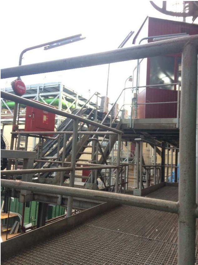
Lugar: EDAR GALINDO Edificio: I08 – Horno 1 Comentario: BIE y sirena.
