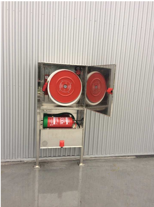
Lugar: EDAR GALINDO Edificio: E19 – Edificio de servicios Comentario: BIE y extintor en el exterior de la planta primera
