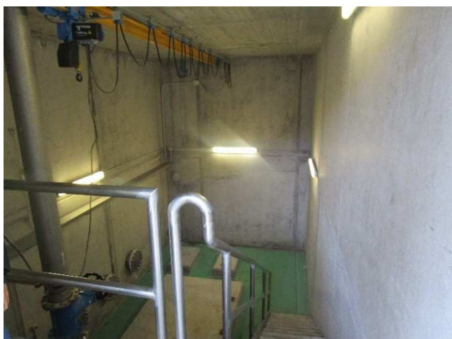
Lugar: EDAR GALINDO Edificio: I17 – Instalaciones de tratamiento terciario Comentario: Vista general de la instalación, zona bajo rasante, donde no se aprecian elementos contra incendios (incorrecto).
