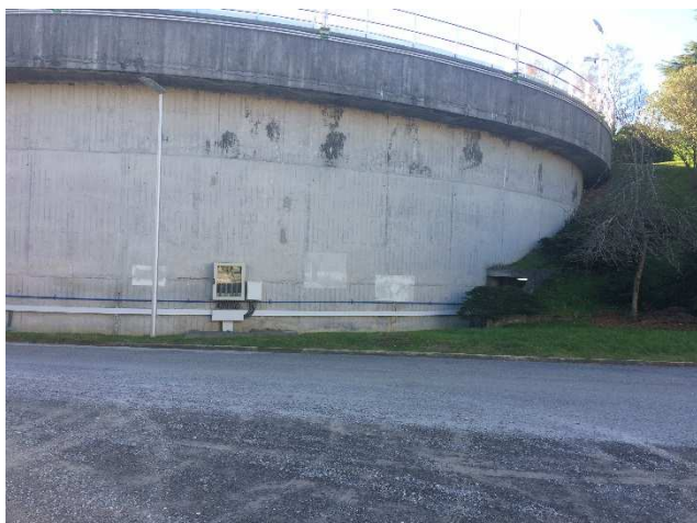
Lugar: ETAP VENTA ALTA Edificio: Nº19 - Decantadores fase II Comentario: Cuadro eléctrico sin alumbrado de emergencia (incorrecto).
