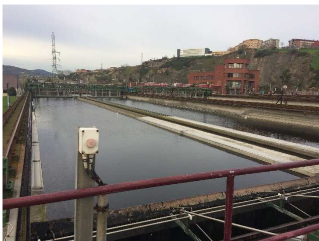
Lugar: EDAR GALINDO Edificio: I05 – Decantación secundaria Comentario: Vista general de la balsa donde no se aprecian elementos contra incendios (incorrecto).
