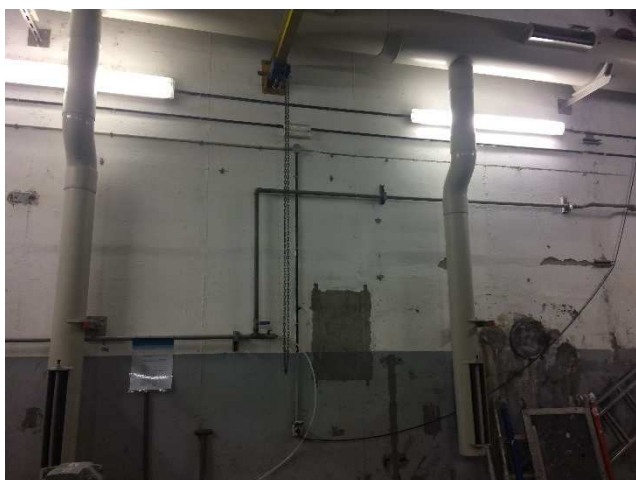
Lugar: EDAR GALINDO Edificio: E05 – Tamizado de Fangos Primarios Comentario: Alumbrado de emergencia.
