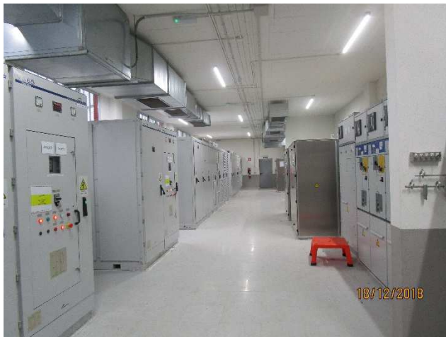
Lugar: EDAR GALINDO Edificio: E27 – CT Biológico Comentario: Planta baja. Sirena, pulsador, extintor frente a salida señalizada.
