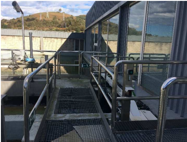
Lugar: ETAP VENTA ALTA Edificio: Nº10 - Decantadores fase I Comentario: Señalización de evacuación.
