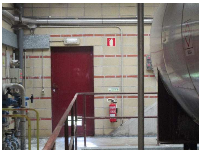
Lugar: EDAR GALINDO Edificio: E17 – Almacenamiento de sosa Comentario: Extintor ABC y alumbrado de emergencia. Salida sin señalizar (incorrecto).
