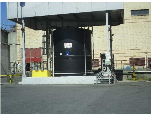
Lugar: EDAR GALINDO Edificio: I22 – Dosificación hipoclorito Comentario: Vista general donde no se aprecian elementos contra incendios (incorrecto).
