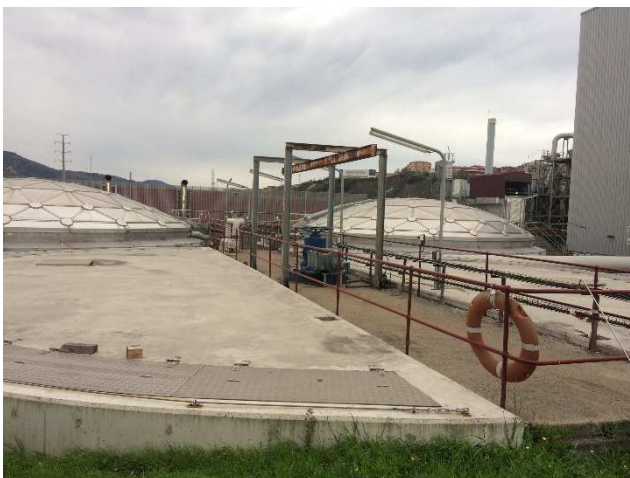
Lugar: EDAR GALINDO Edificio: I07 – Espesamiento de fangos Comentario: Vista general de la instalación donde no se aprecian elementos contra incendios (incorrecto).
