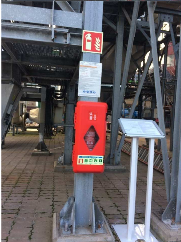
Lugar: EDAR GALINDO Edificio: I08 – Horno 1 Comentario: Extintor ABC.
