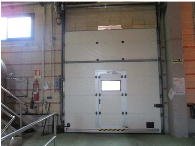
Lugar: EDAR GALINDO Edificio: E20 – Tratamiento terciario Comentario: Sirena, extintor y señalización de la puerta de salida
