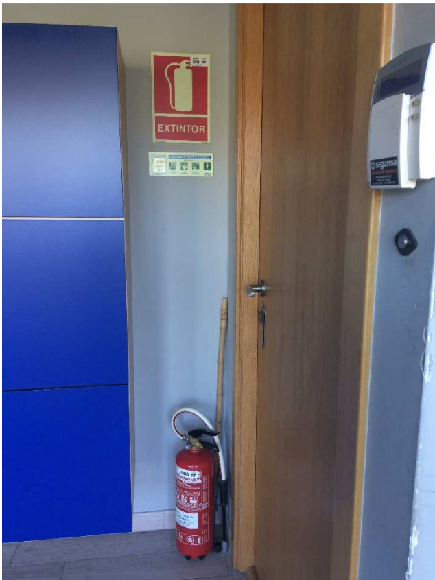
Lugar: ETAP VENTA ALTA Edificio: N°29 - Control de acceso Comentario: Extintor polvo ABC mal colocado (incorrecto).
