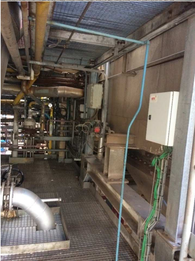
Lugar: EDAR GALINDO Edificio: I08 – Horno 1 Comentario: Cuadro eléctrico sin alumbrado de emergencia (incorrecto).
