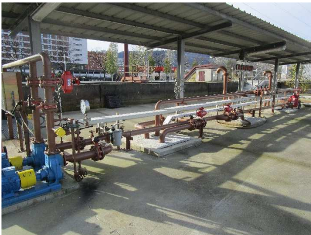
Lugar: EDAR GALINDO Edificio: I10 – Depósitos energía emergencia Comentario: Extintor de carro.
