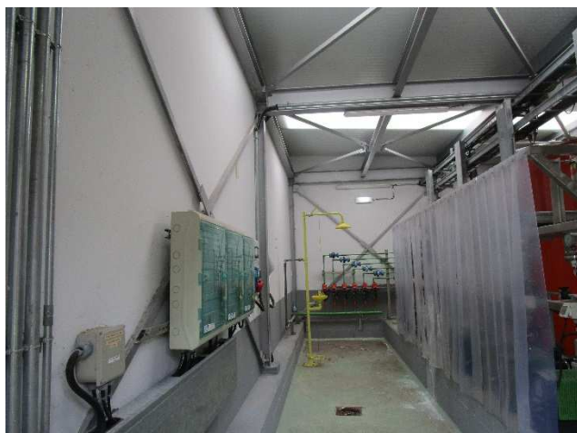
Lugar: EDAR GALINDO Edificio: E17 – Almacenamiento de sosa Comentario: Cuadros eléctricos sin alumbrado de emergencia (incorrecto).
