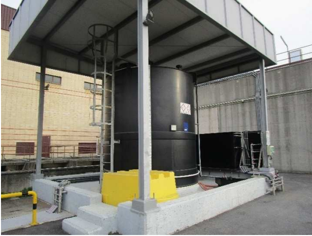
Lugar: EDAR GALINDO Edificio: I22 – Dosificación hipoclorito Comentario: Vista general.
