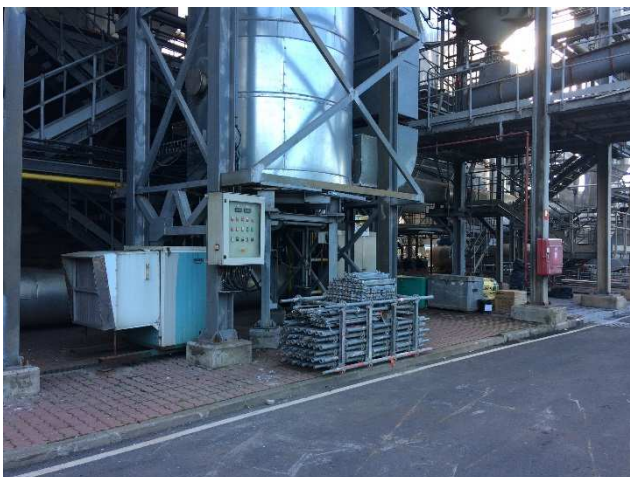
Lugar: EDAR GALINDO Edificio: I09 – Horno 2 Comentario: Extintor ABC.
