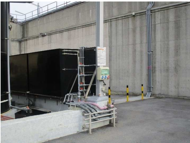
Lugar: EDAR GALINDO Edificio: I22 – Dosificación hipoclorito Comentario: Cuadro eléctrico sin alumbrado de emergencia (incorrecto).
