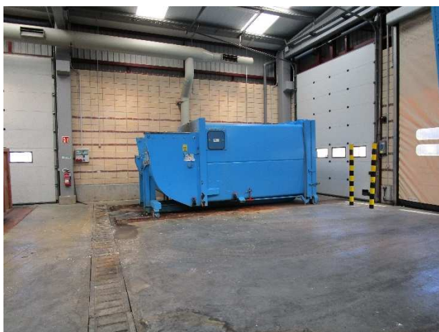
Lugar: EDAR GALINDO Edificio: E21 – Almacén de contenedores Comentario: Extintor ABC junto a la salida.
