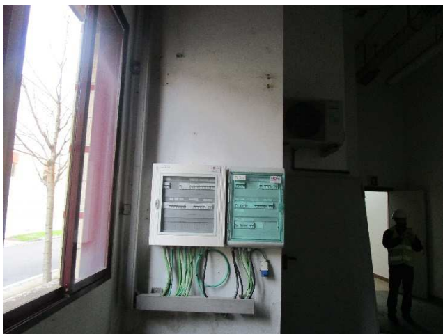
Lugar: EDAR GALINDO Edificio: E15 – Almacén y Vestuarios Comentario: Cuadros eléctricos sin alumbrado de emergencia (incorrecto).
