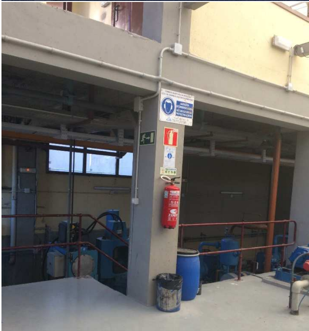
Lugar: ETAP VENTA ALTA Edificio: Nº15 - Edificio de secado Comentario: Extintor Polvo ABC y señalización de recorrido de evacuación.
