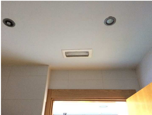
Lugar: ETAP VENTA ALTA Edificio: Nº29 - Control de acceso Comentario: Alumbrado de emergencia.
