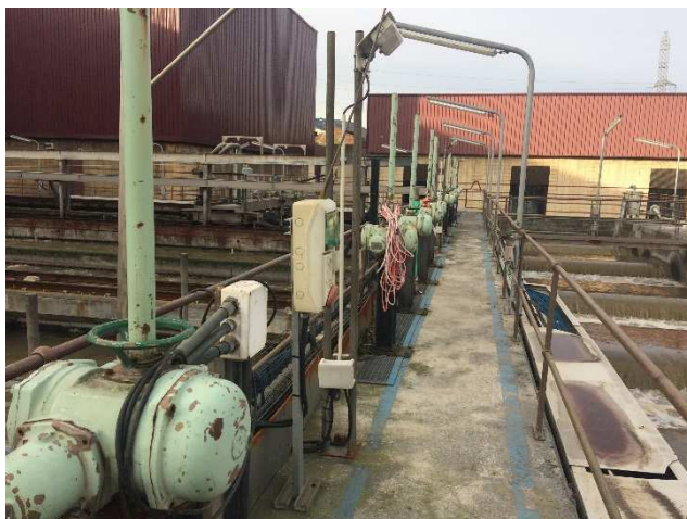
Lugar: EDAR GALINDO Edificio: I01 – Desarenado Comentario: Zona transitable de la instalación. Posible recorrido de evacuación sin señalar (incorrecto).
