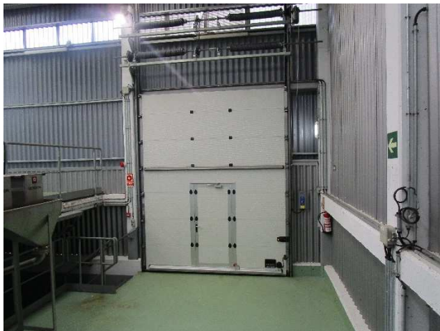
Lugar: EDAR GALINDO Edificio: E24 – Rototamices Comentario: Pulsador, extintor y sirena. Salida sin señalizar (incorrecto).
