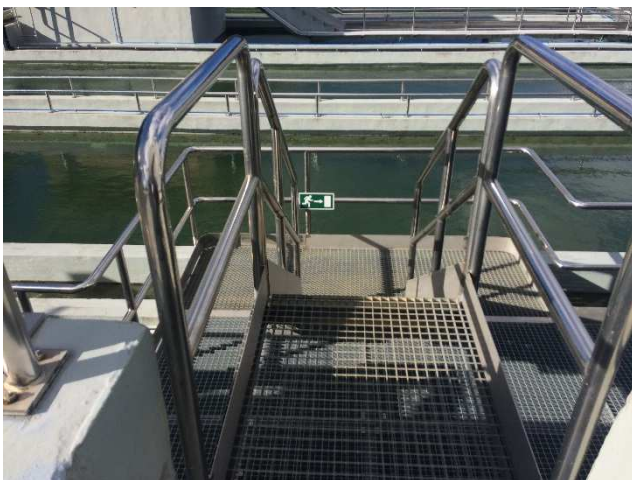
Lugar: ETAP VENTA ALTA Edificio: Nº10 - Decantadores fase I Comentario: Señalización del recorrido de evacuación.
