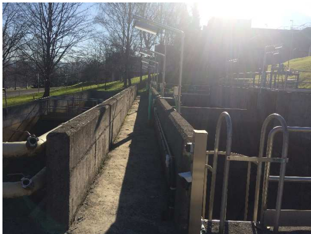
Lugar: EDAR GALINDO Edificio: Nº17 – Balsas de lodos Comentario: Vía de evacuación sin señalizar (incorrecto).
