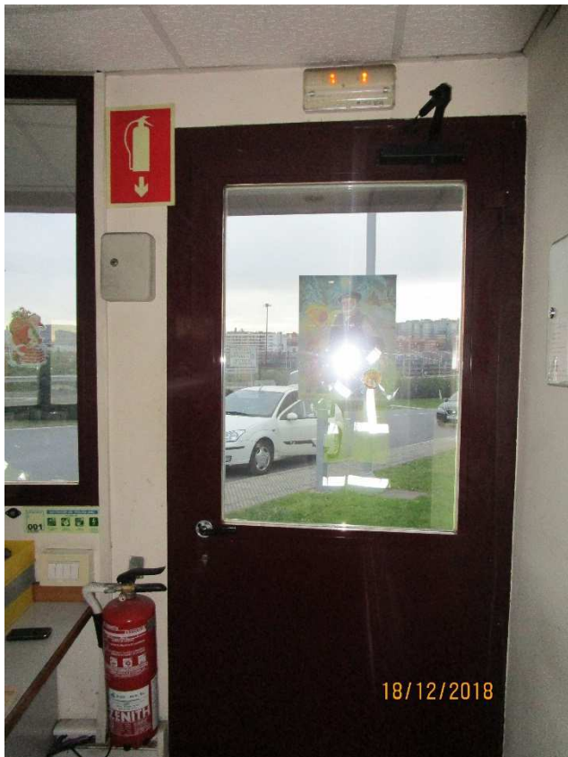
Lugar: EDAR GALINDO Edificio: E16 – Control de accesos Comentario: Extintor y alumbrado de emergencia. Salida sin señalizar (incorrecto).
