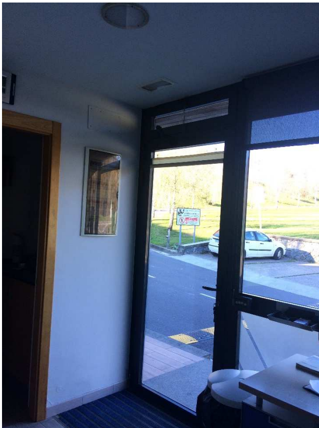
Lugar: ETAP VENTA ALTA Edificio: Nº29 - Control de acceso Comentario: Alumbrado de emergencia en salida sin señalizar (incorrecto).
