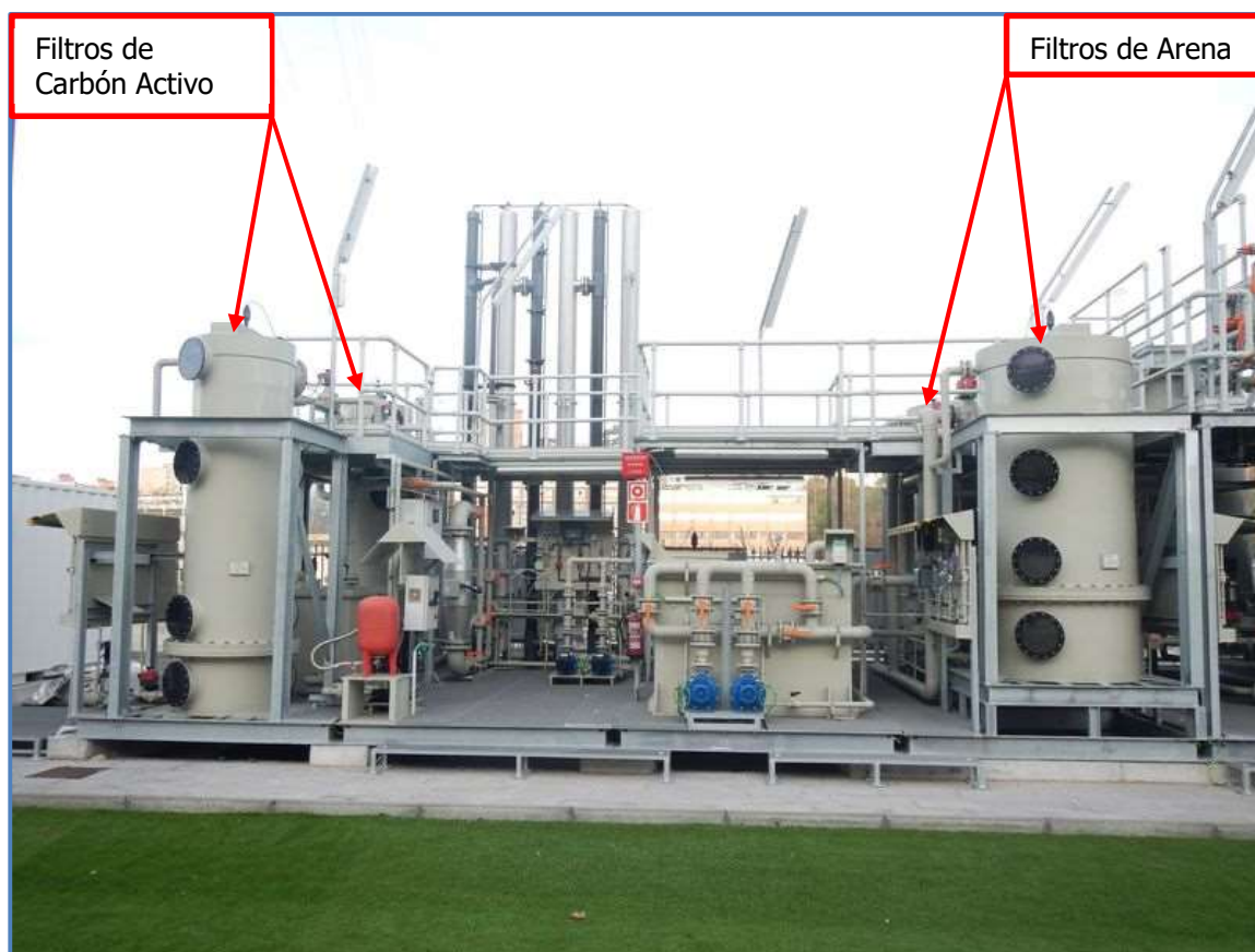
Fig. 16. Sistema de lavado a filtros de arena y carbón activo y tanque
