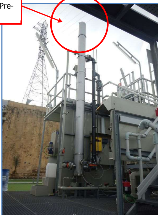
Fig. 12. Columna atmosférica (pre-ozonización)
