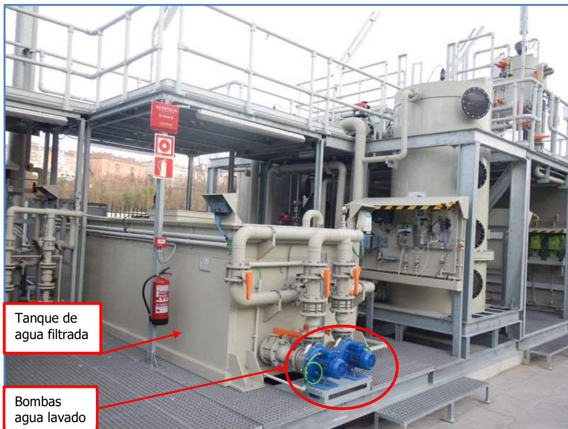
Fig. 15. Sistema de lavado a filtros de arena y carbón activo y tanque
