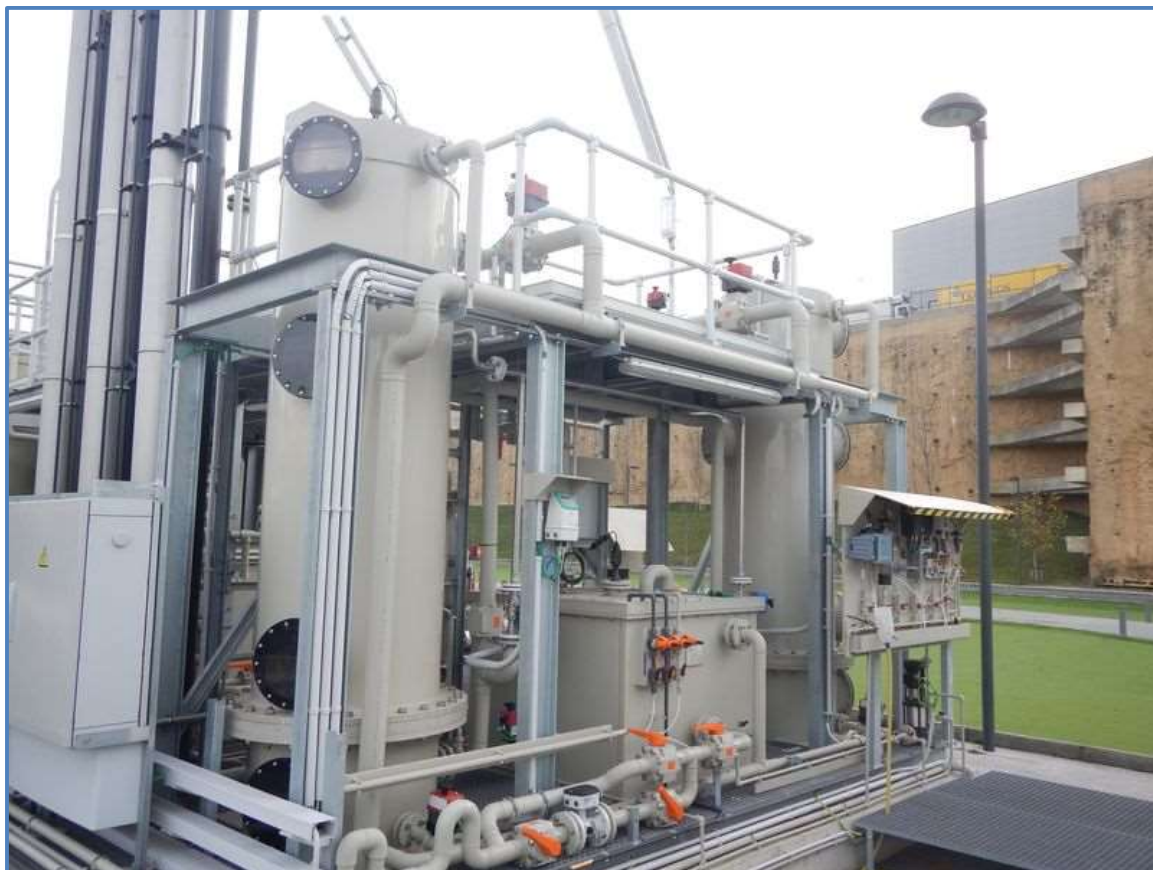
Fig. 19. Filtros de Carbón Activo
