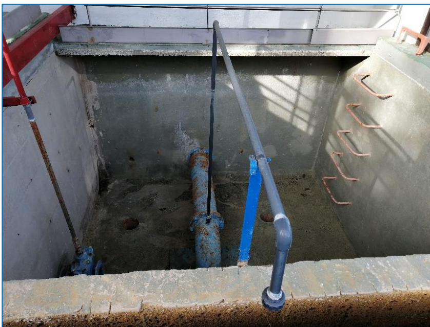
Vista del filtro de arena N°4 de la ETAP de Gorozika
