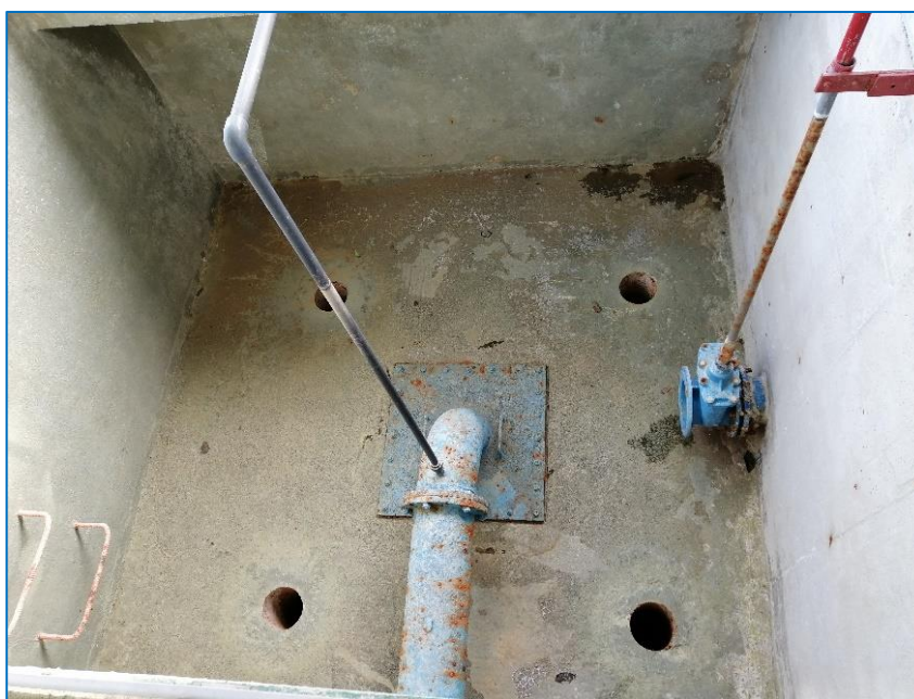
Vista Superior del filtro de arena
