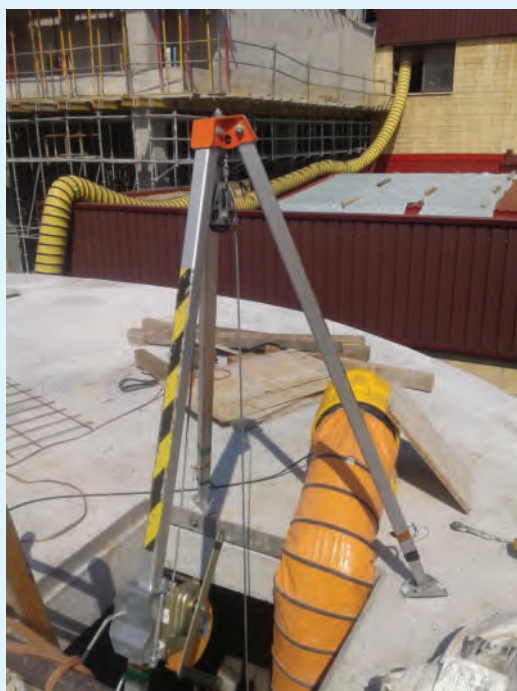
Acceso con trípode rescatador y ventilación forzada
