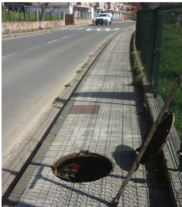
Imagen 8. Arqueta de acometida a polígono de Aranguren y llave general de corte (DN150)
