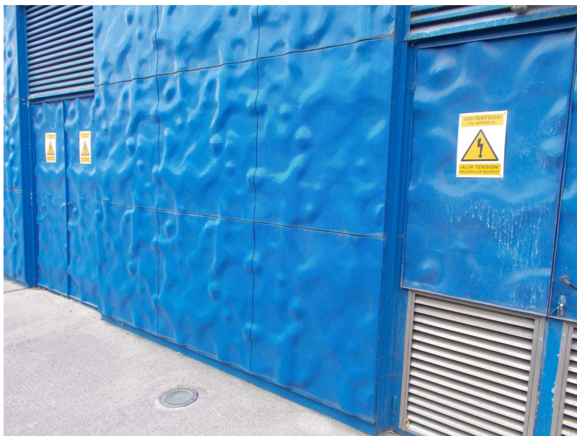
Imagen 1. Puertas de acceso a las celdas de AT y al transformador.
