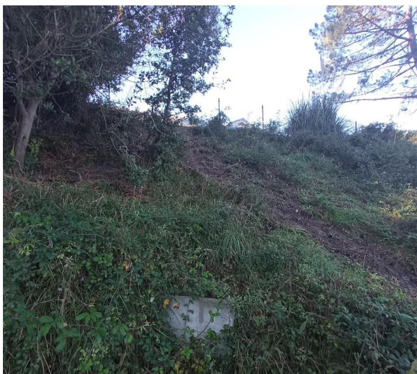
Salida del desagüe del depósito de Sopela-2 en la parcela privada
