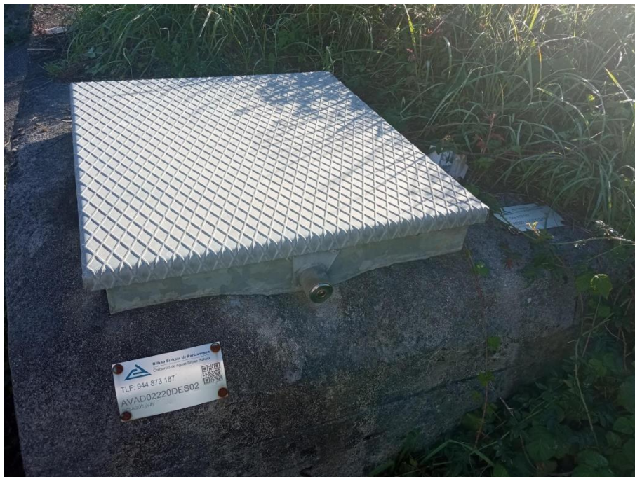
Arqueta desagüe de primaria
