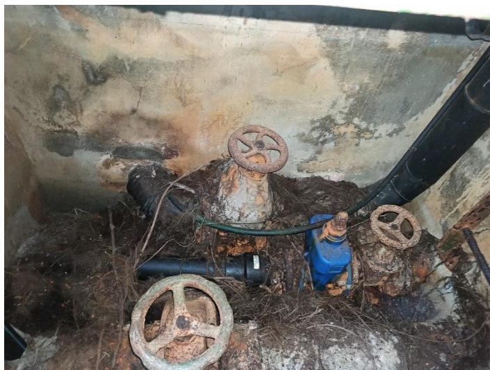
Distribución a Igartua, desagüe y antiguo llenado
