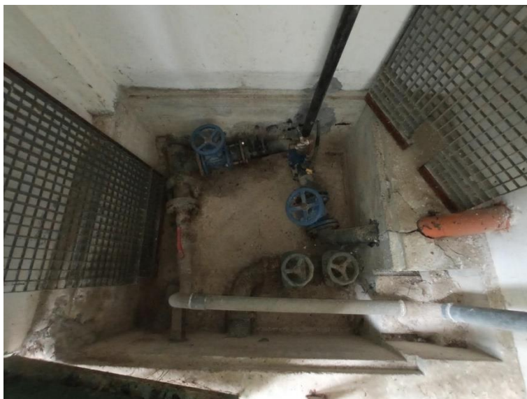
Mecanismos en la sala de válvulas
