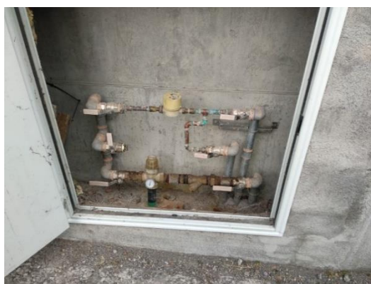
Cuadro de llaves y contadores de la Vivienda n.º 51.
