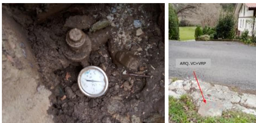
Arqueta acometida y reductora domiciliaria al n.º 38.
