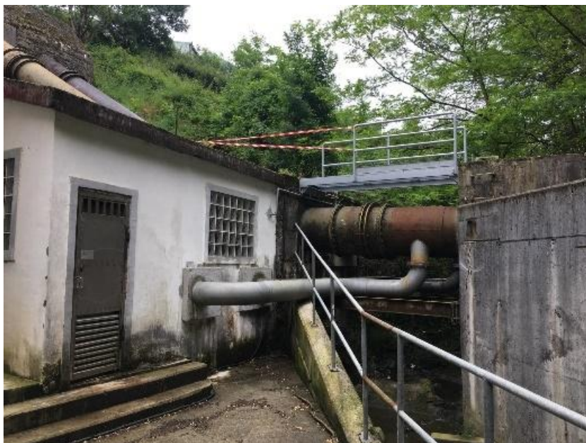
Figura 1.3. sala de válvulas del ámbito de estudio.
