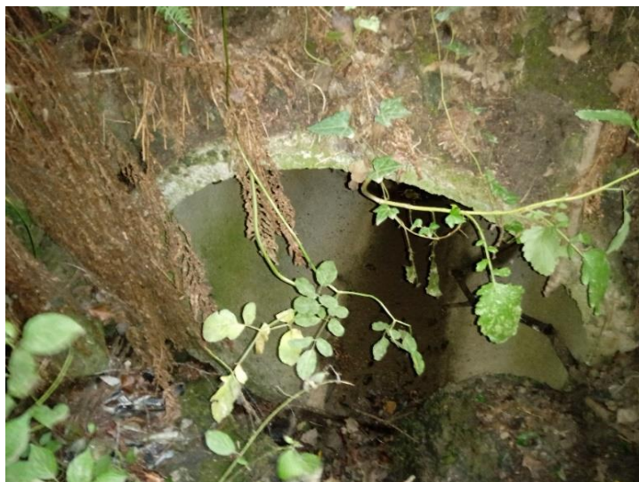
Cruce entubado del arroyo innominado (ID 8862)
