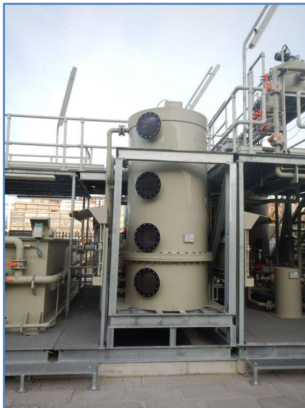
Fig. 14. Filtro de Arena
