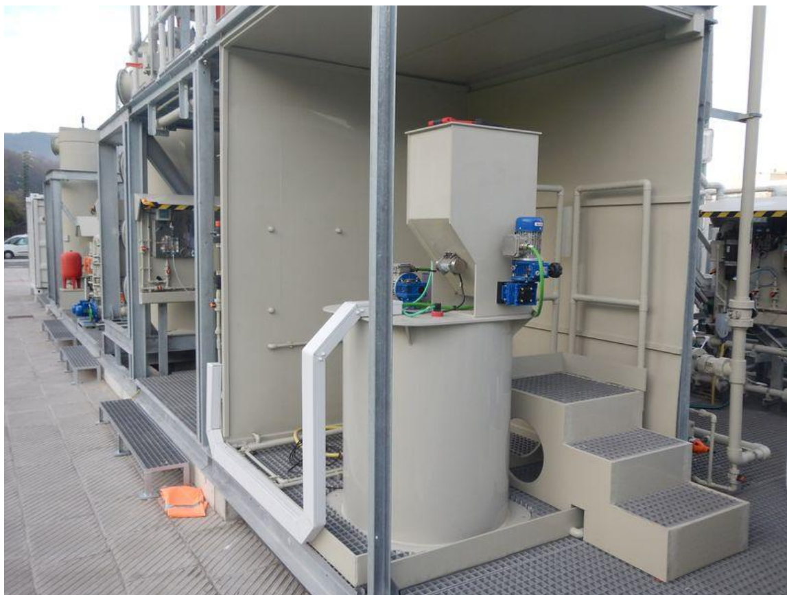
Fig. 20 Instalación de Almacenamiento y Preparación de Carbón Activo
