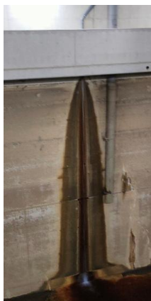
Fig: 12 - Imagen de la bajante de los baños y la conducción de olores en el tanque de tormentas
