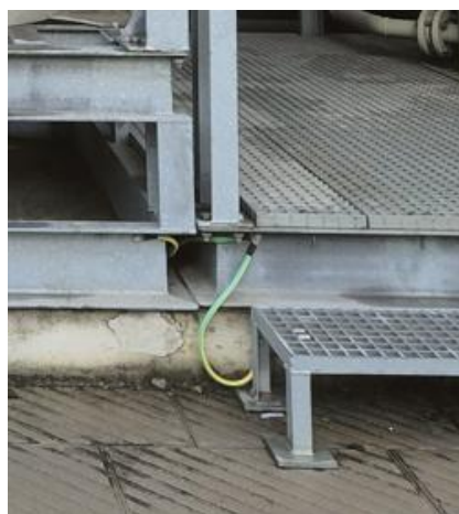
Fig: 13 - Imagen de la conexión de tierras de las estructuras metálicas
