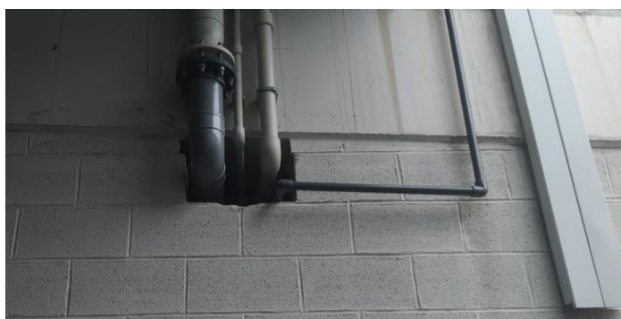
Fig: 16- Imagen de las aberturas por las que los servicios salen a la plataforma de la cota +30
