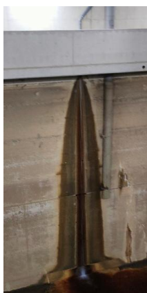
Fig: 6 - Imagen de la bajante de los baños y la conducción de olores en el tanque de tormentas
